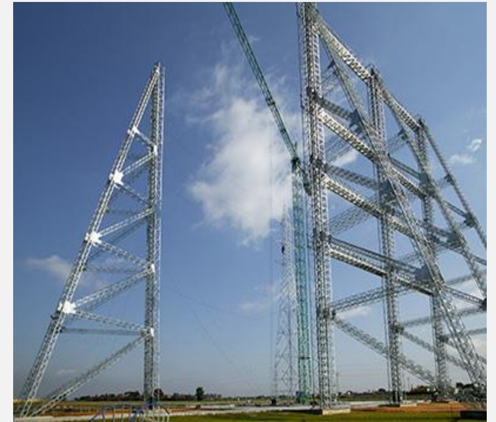
Estación de ensayos de estructuras
