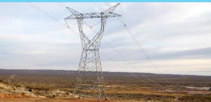
LT 500kV Comahue-Cuyo (Tramo Sur) - ET Agua del Cajón (Argentina)
