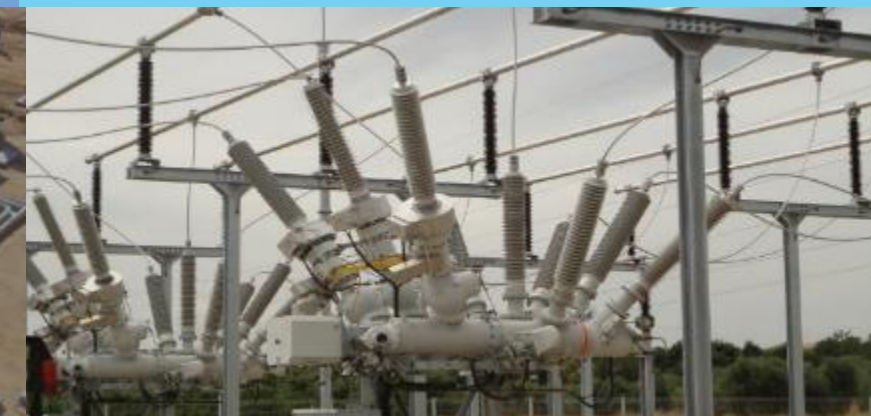
SE Híbrida 132kV Pabellones (España)
