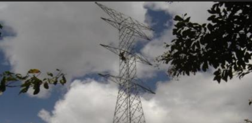
Interconexión eléctrica América Central - 955km LAT 230kV
