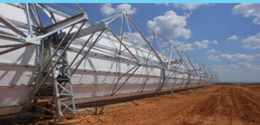
Solabén Solar CCP (España) – 2520 uts
