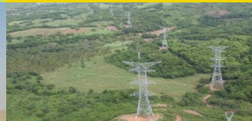
Red de Transmisión 400kV asociada a El Pacifico (1° Fase) (México)
