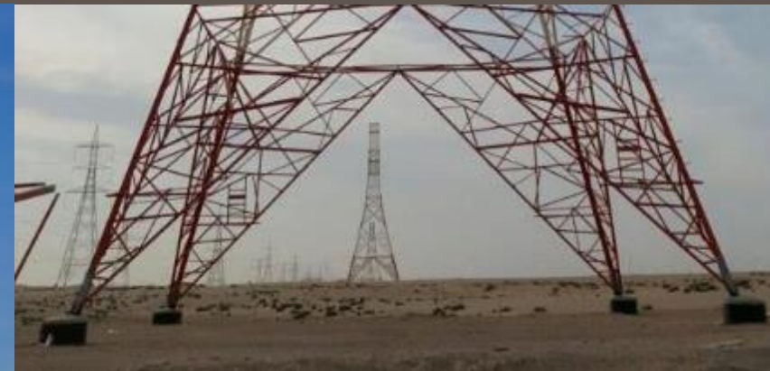
LAT Faya-Shamkha (EAU) LAT 400 y 220 kV
