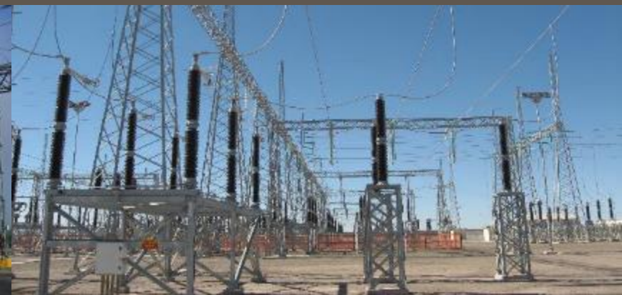
Subestación 220 kV Sierra Gorda (Chile)
