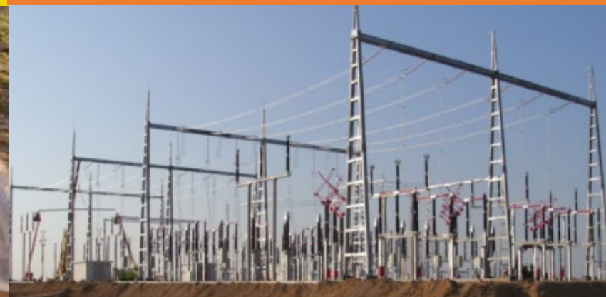
SE 400kV Cerrato - REE (España)
