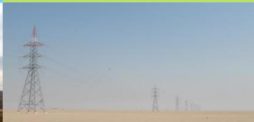
Línea 132kV Shagaya (Kuwait)
