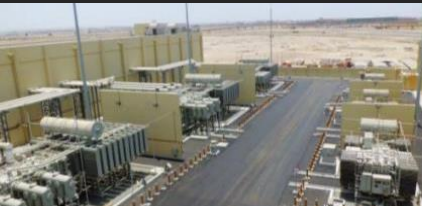
SSEE GIS 380/132/13.8kV en Riyadh y Jeddah (Arabia Saudí)
